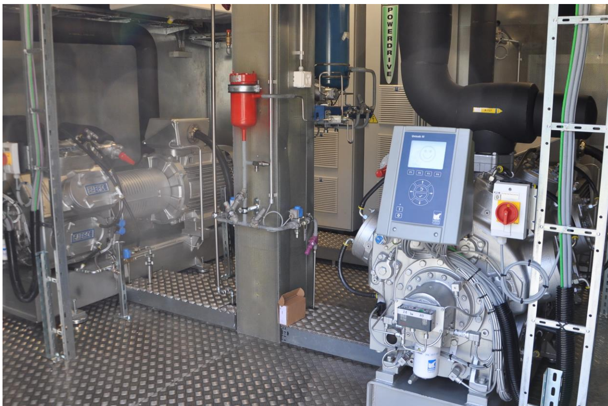
Blick in die Wärmepumpenzentrale der BeoTherm AG auf dem Gelände der ARA Region Interlaken
