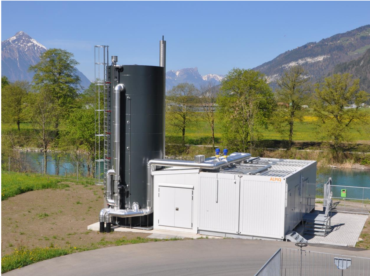
Bild: Die Wärmepumpenzentrale der BeoTherm AG auf dem Gelände der ARA Region Interlaken
